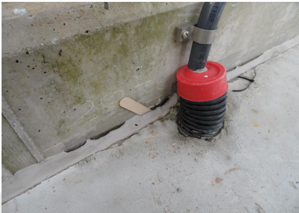
Foto: Gebrek in een afdichting.
